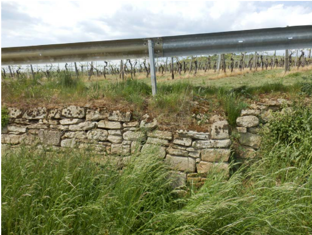
Bild 03: Nur kleinfächig ist die Vegetation der Mauerkrone etwas lückiger
