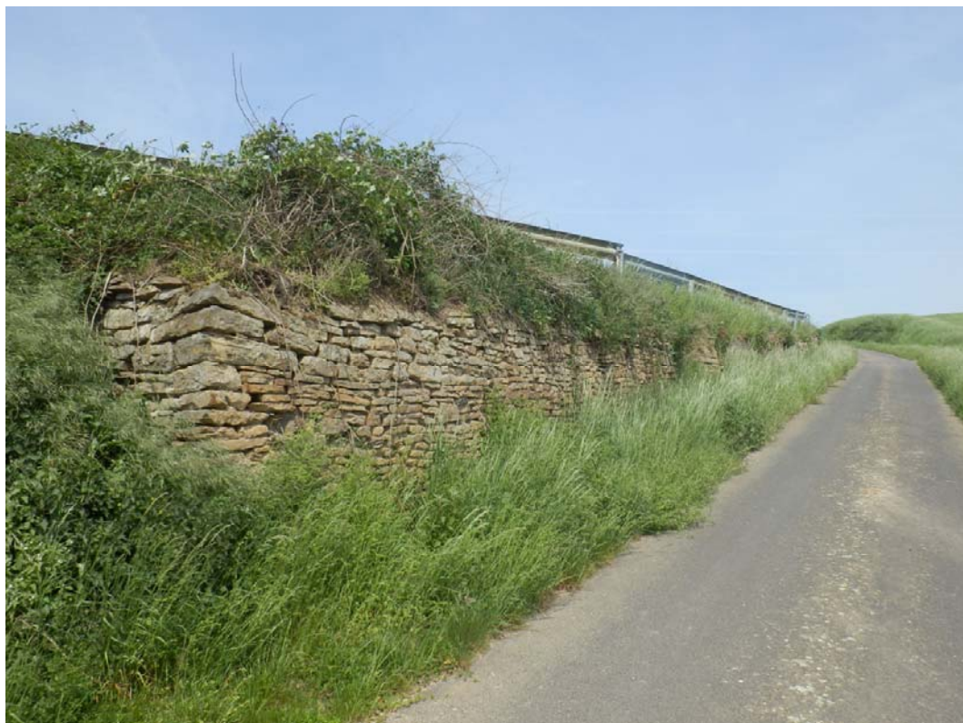
Bild 02: Sowohl Mauerkrone als auch Mauerfuß der Trockenmauer sind dicht bewachsen
